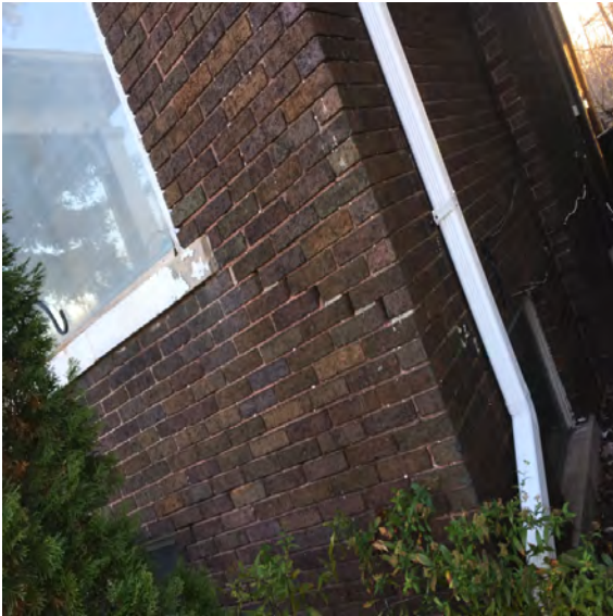
Possible Foundation Damage (Wall A)
