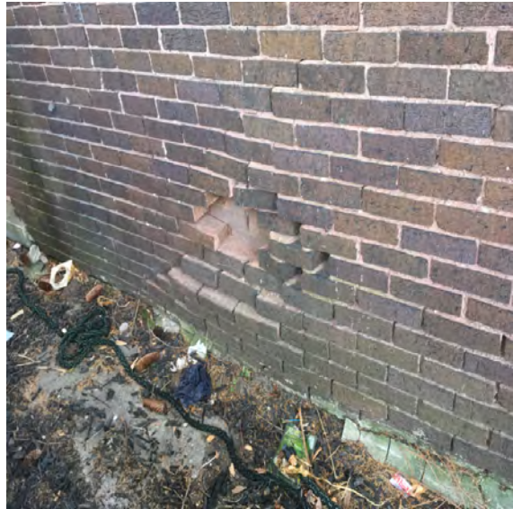
Possible Foundation Damage (Wall B)
