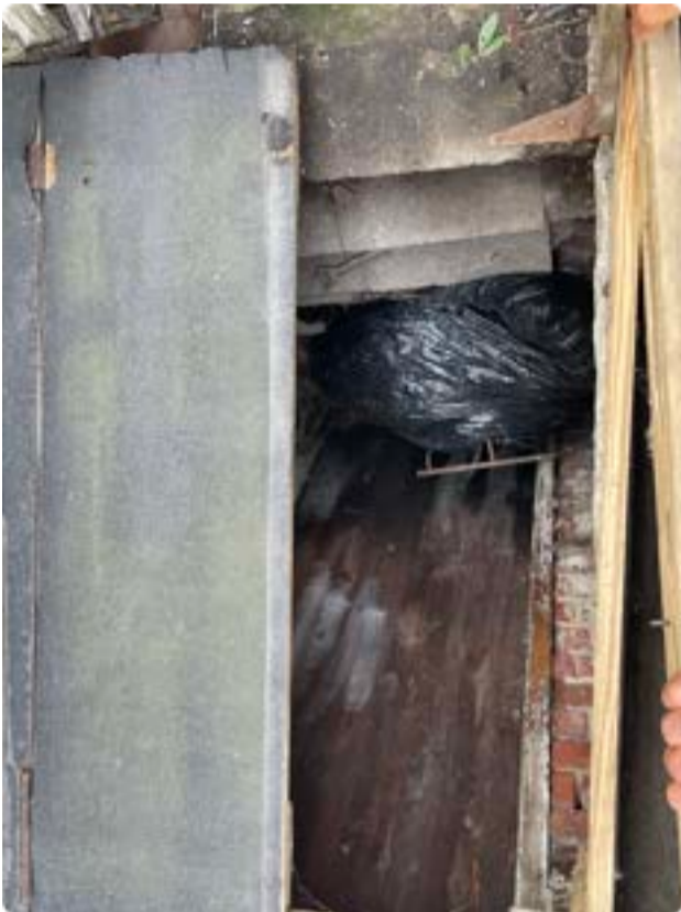
Rotted, broken Bulkhead door
